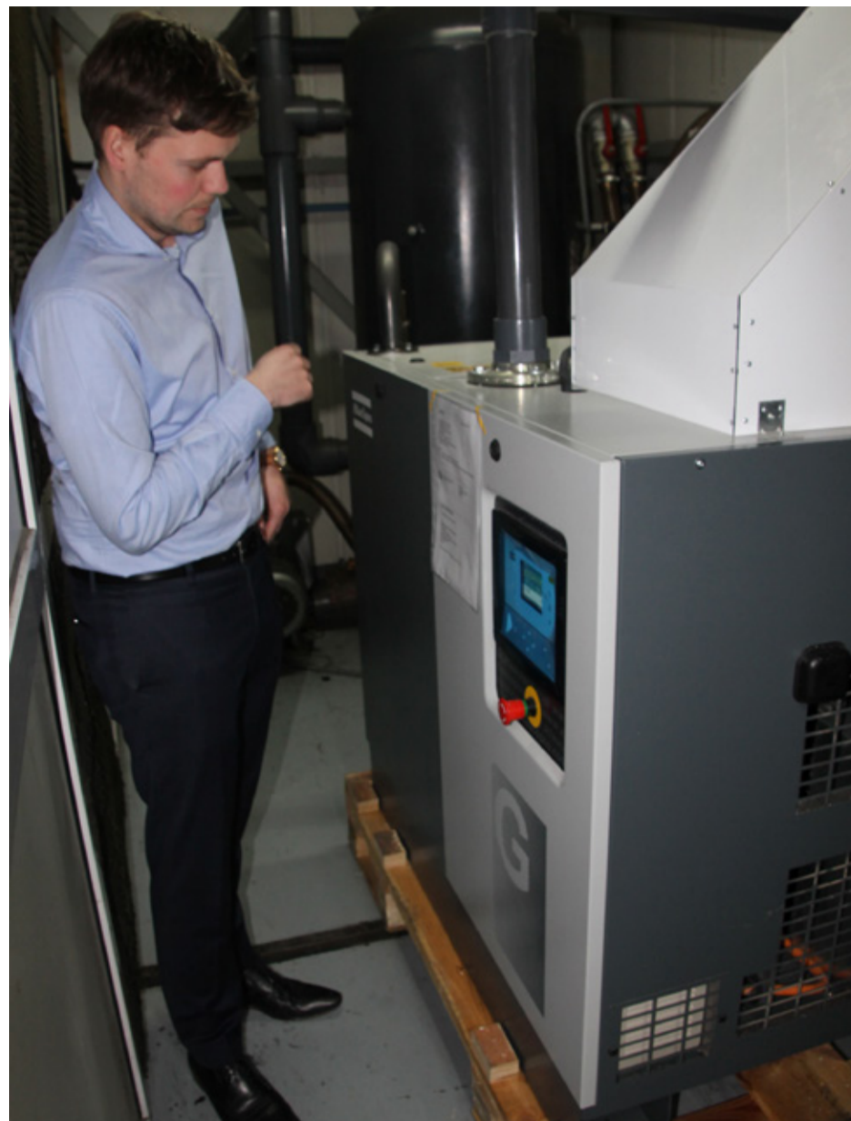
Alexander Ferichs van Atlas Copco Nederland controleert de werking van de vacuümschroefpomp
