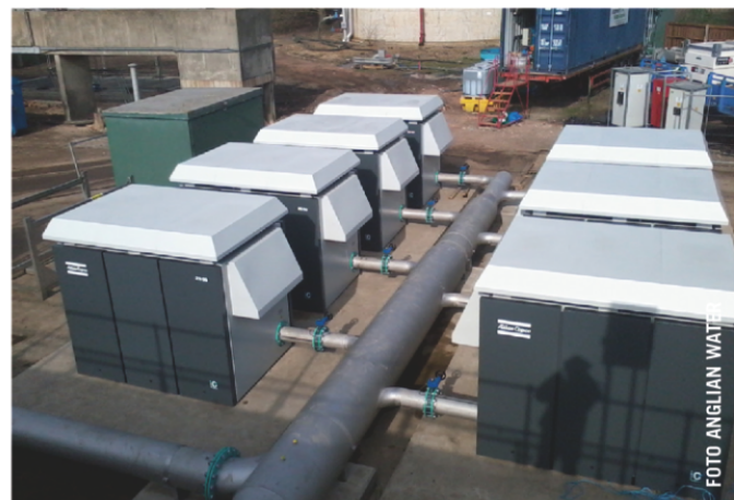
I SOFFIATORI ZS A BASSA PRESSIONE FORNISCONO ARIA AI DIFFUSORI PER AERAZIONE NEGLI IMPIANTI TRATTAMENTO ACQUE
