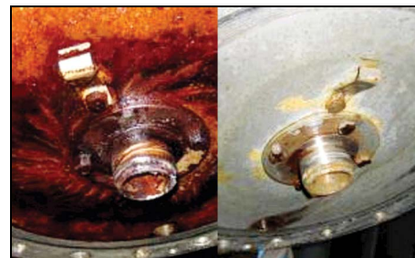
Bouchon cuve contaminée
